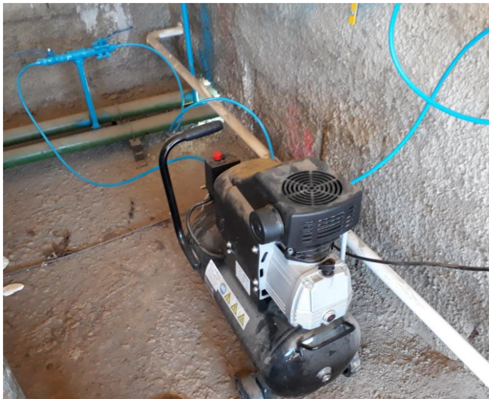
Figura 6 – Compressor de ar
