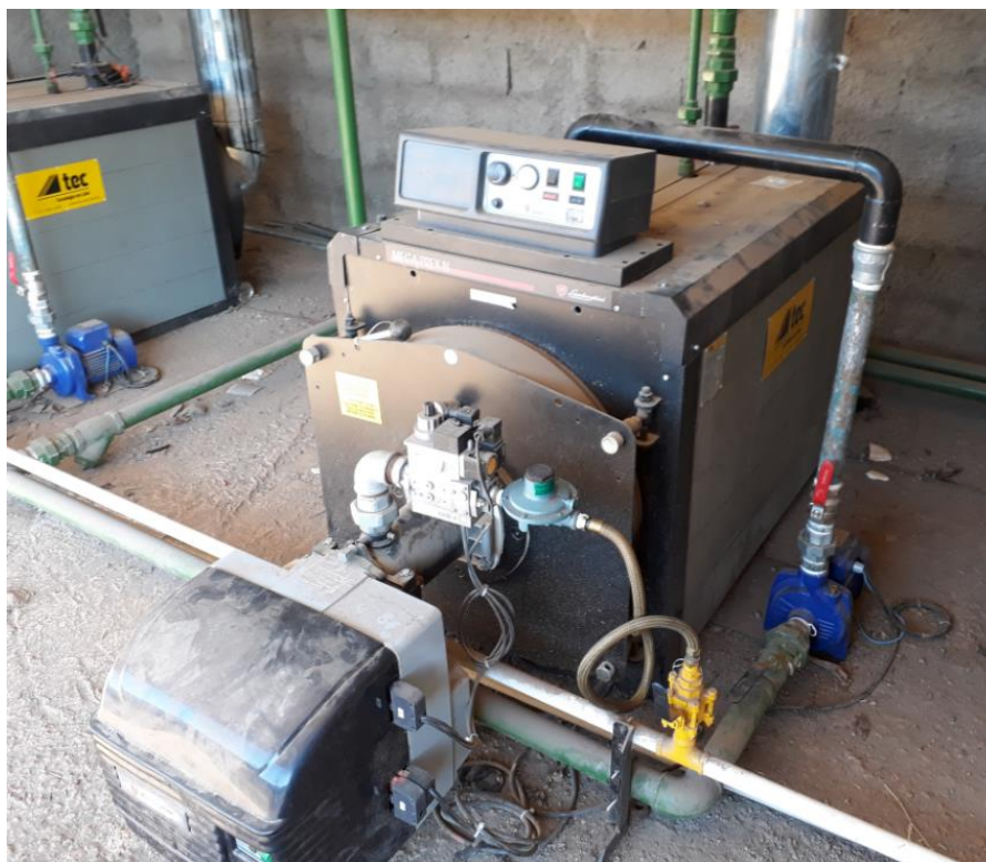
Figura 3 – Gerador de Água Quente
