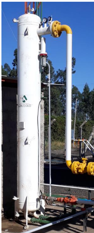
Figura 2 – Vaporizador de GLP (trocador de calor – água quente)
