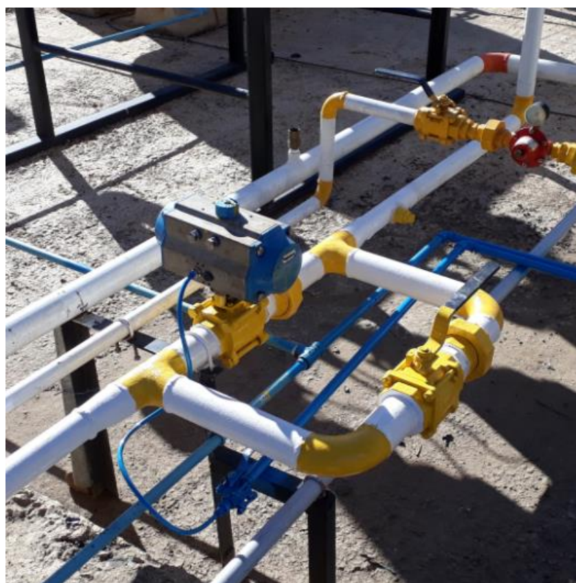
Figura 7 – Quadro By-pass com válvula esfera e atuador pneumático para back-up do vaporizador de GLP
