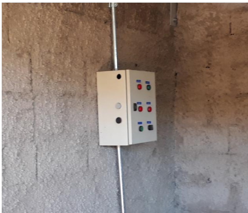
Figura 5 – Painel de Controle
