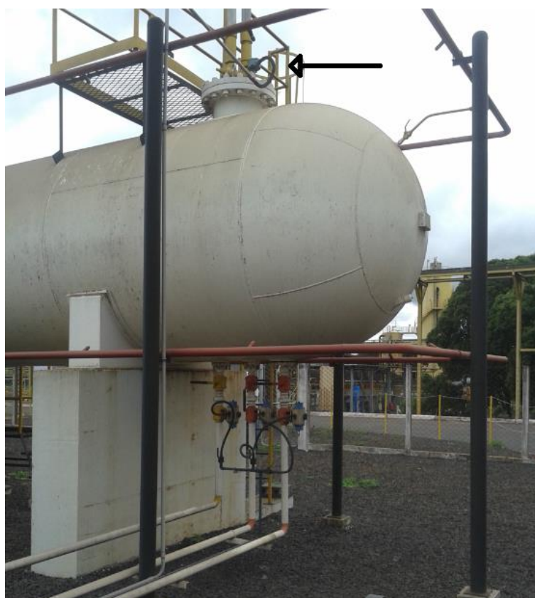
Figura 6 – Chave de nível Instalada
