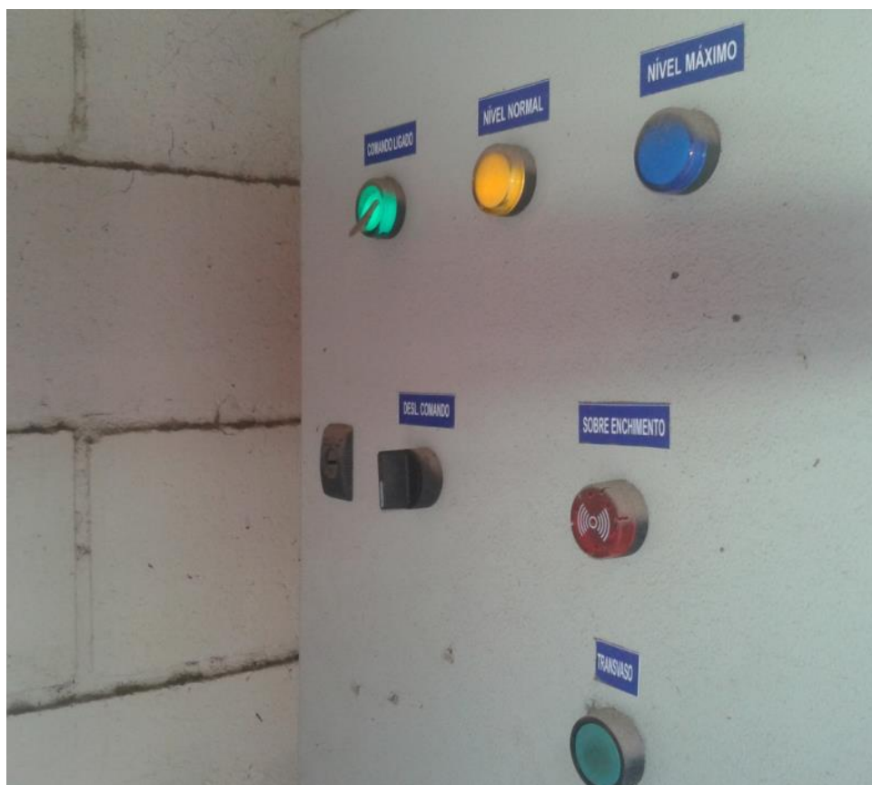
Figura 8 – Painel de comandos elétricos
