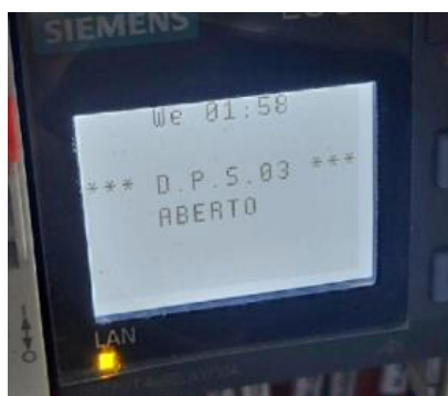
Figura 16: Indicação de abertura de um dos DPS do conjunto.
