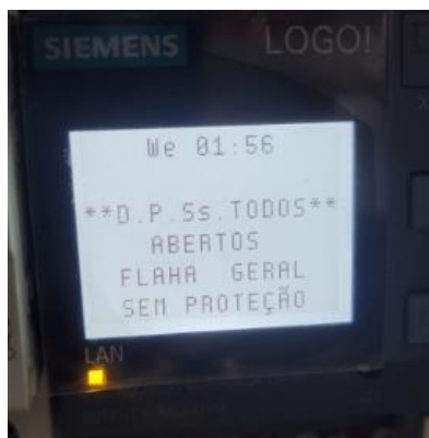
Figura 17: Indicação de abertura de todos os DPS e alerta de FALHA GERAL SEM PROTEÇÃO.
