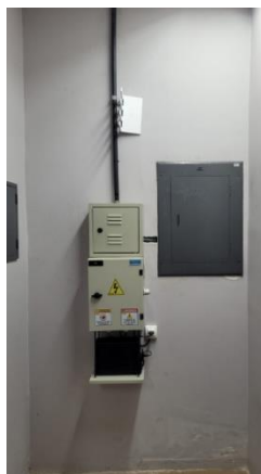
Figura 9: Infraestrutura do sistema de monitoramento do DPS 01.
