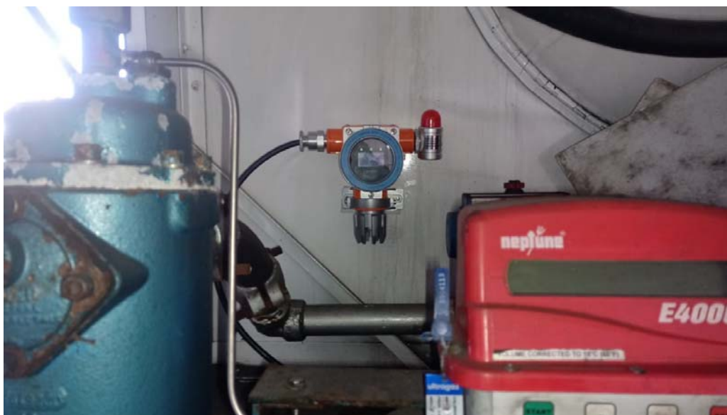
Figura 6 - Local de instalação do detector na capela. Fonte: KRAFT COMÉRCIO E SERVIÇOS INDUSTRIAIS LTDA, 2025
