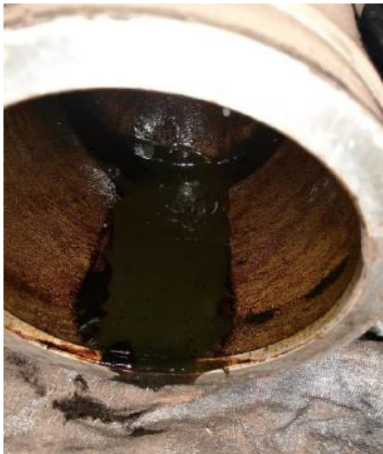
Figura 7: Presença de resíduo oleoso no bocal do queimador.
