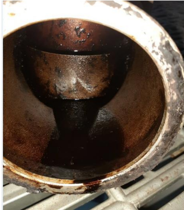
Figura 1: Bocal de queimador com presença de resíduos.
