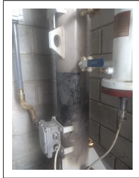
FIGURA 4 – VAPORIZADOR COM SUPERAQUECIMENTO DEVIDO AO NÃO DESLIGAMENTO DA RESISTÊNCIA (PINTURA CARBONIZADA)
