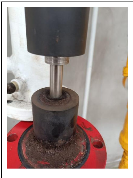
FIGURA 5 – BOIA DE NÍVEL INFERIOR TRAVADA DEVIDO AO ACÚMULO DE SUJEIRA NA LINHA
