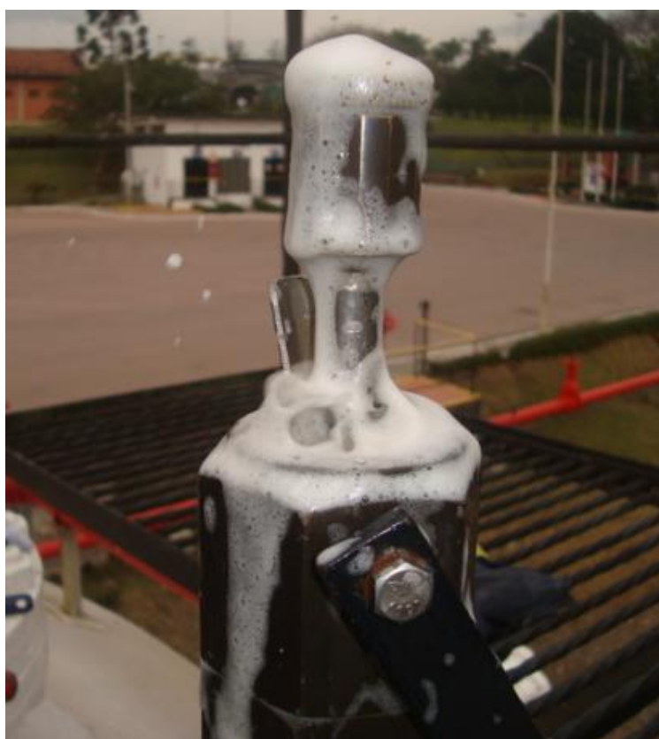
Foto 1 – Bolha indicando sinais de vazamento
