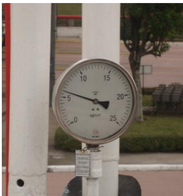
Foto 11: Manômetro indicando a pressão de operação do tanque
