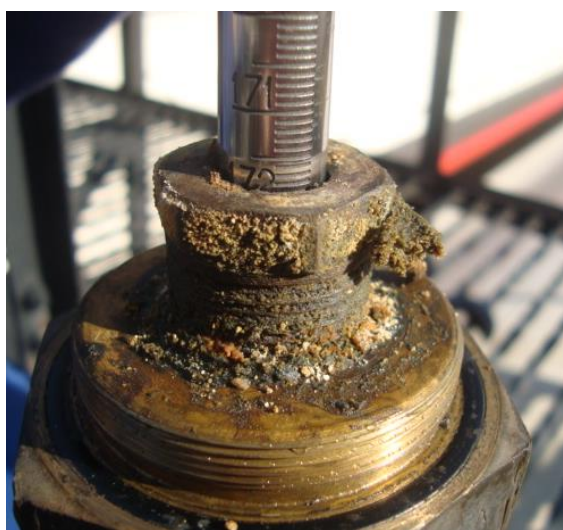
Foto 3: Estado das gaxetas com aproximadamente 9 meses de instalação
