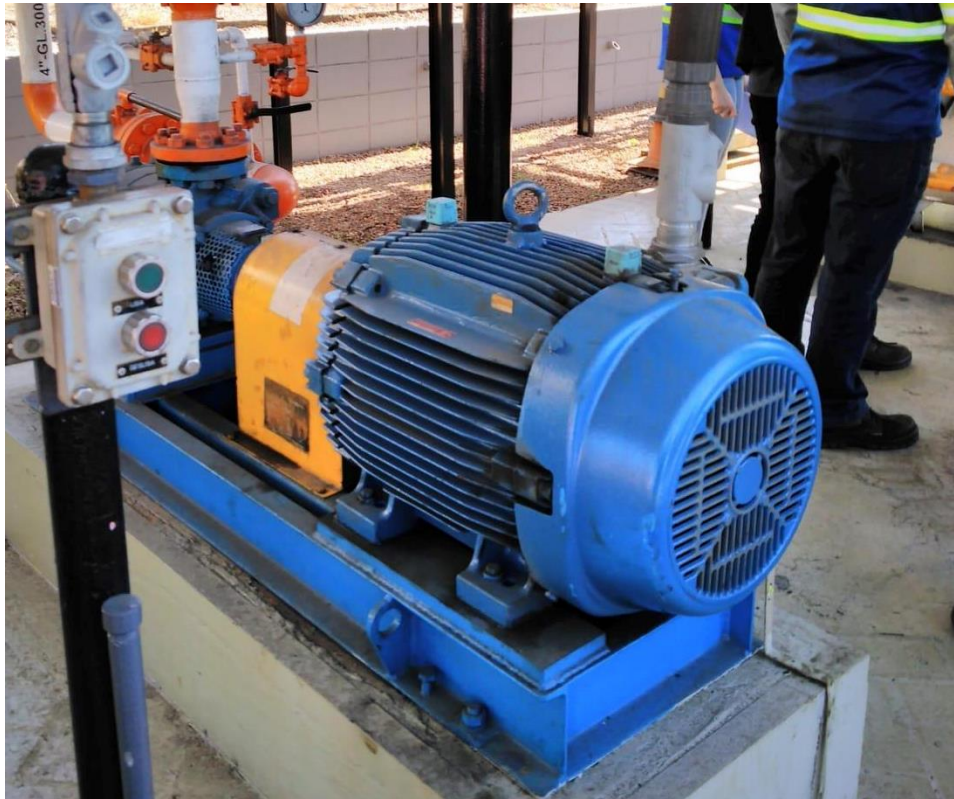
Figura 10: Sensores instalados em conjunto de motor e bomba de GLP
