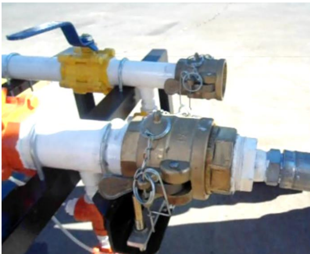
Figura 8 – Mangote de GLP conectado / sistema despressurizado.
