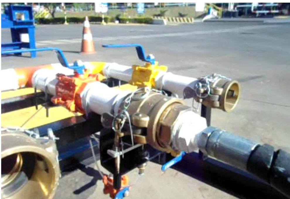
Figura 11 – Detalhe do sistema pressurizado, trava mangote de GLP acionado.
