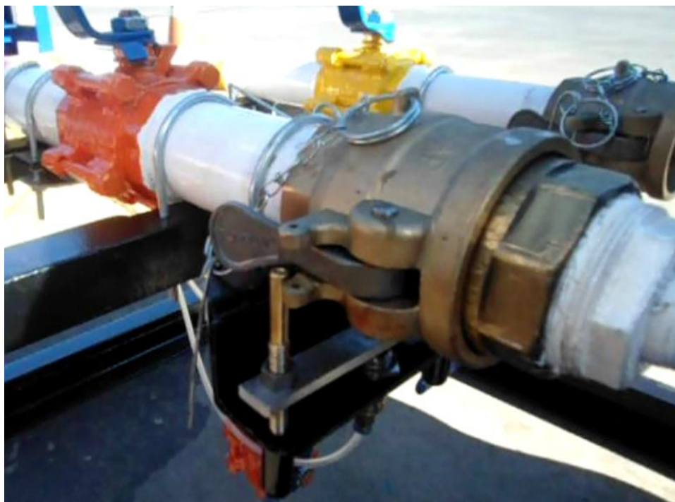
Figura 14 - Detalhe do sistema despressurizado, trava mangote de GLP liberado.
