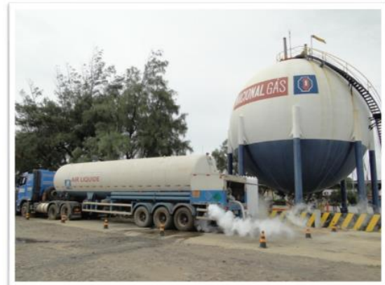
Purga sob pressão Nitrogênio
