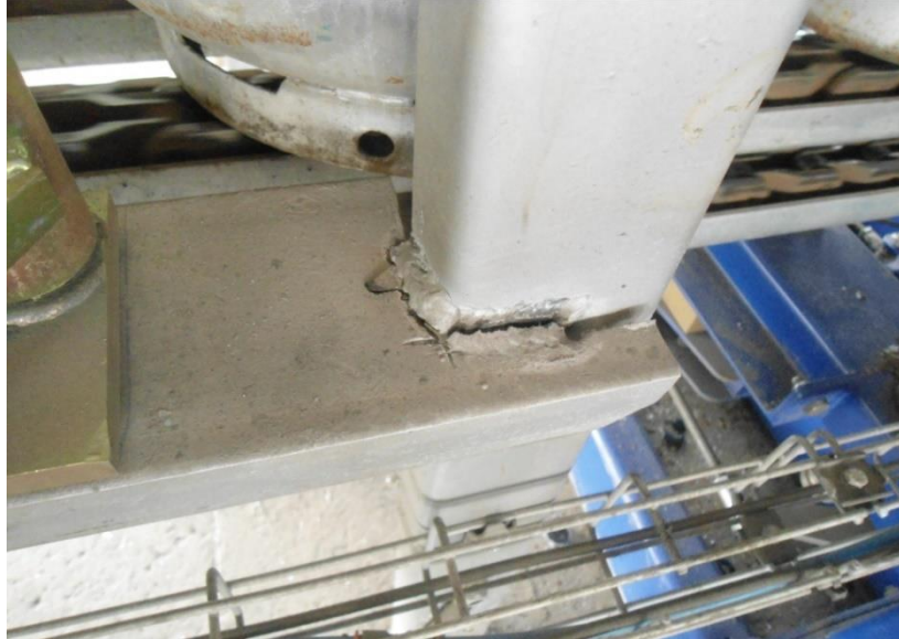
Figura 3 - Falha em um componente devido ao processo defeituoso de soldagem.
