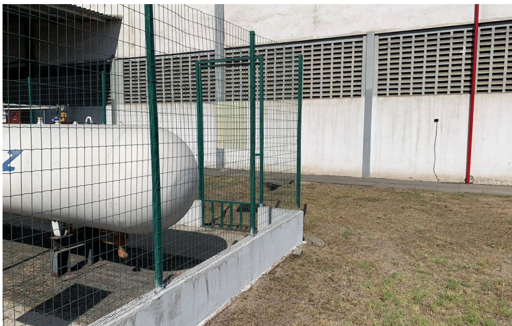
Figura 19 – Vista externa da caixa de dados do sistema de telemetria desse projeto
