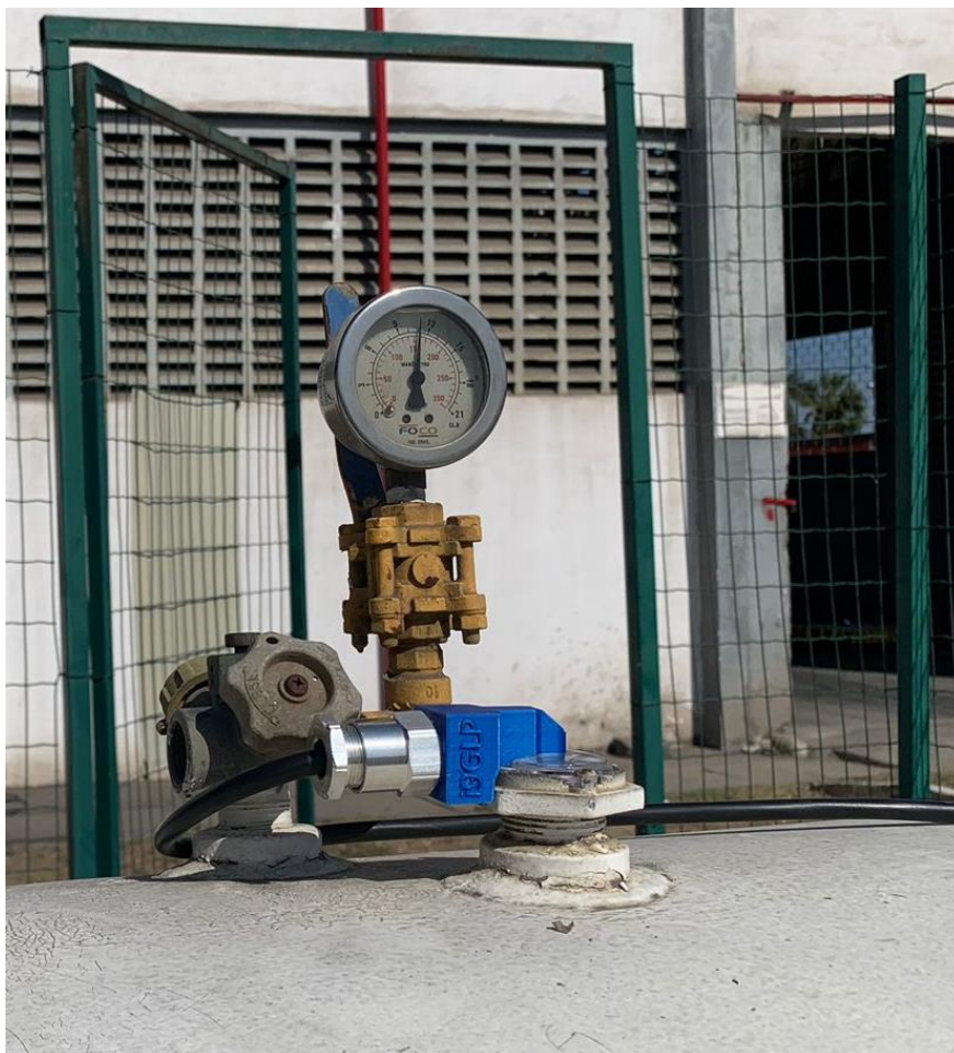
Figura 17 – Sensor de dados acoplado no magnetron do tanque estacionário P2000H
