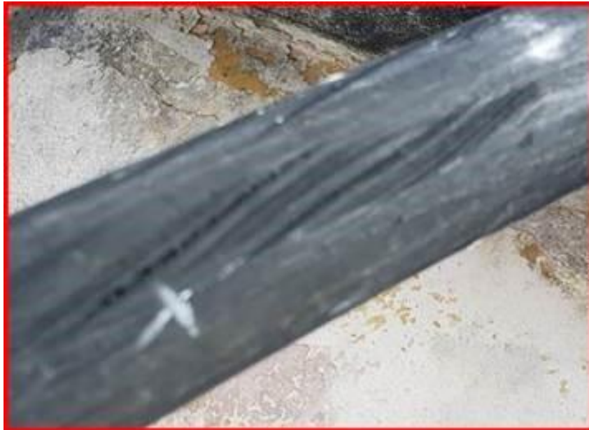
Desgaste da mangueira comprometendo sua vida útil com possibilidade de rompimento
