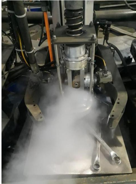
Figura 05 – Nevoa de GLP ao desmontar a cabeça de enchimento.
