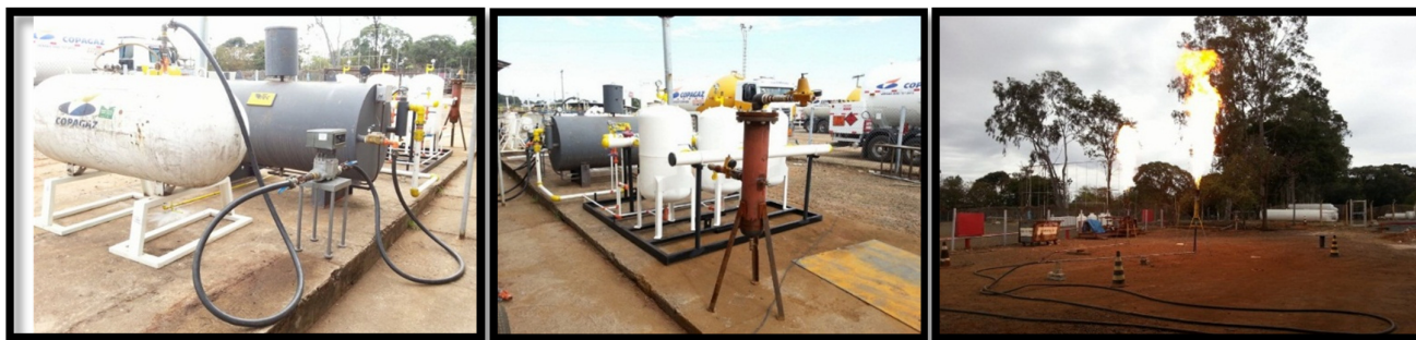
Imagens 3, 4 e 5 – Montagem de central para o primeiro teste de vazão
