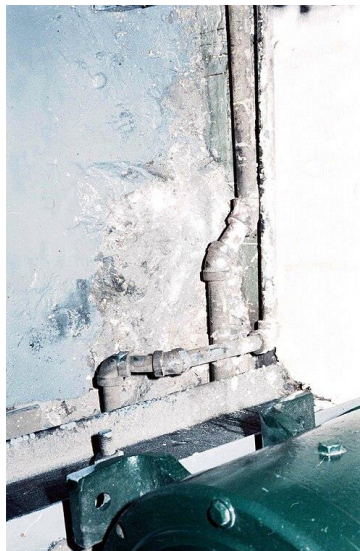
Figura 1 - Corrosão de Tubulação
