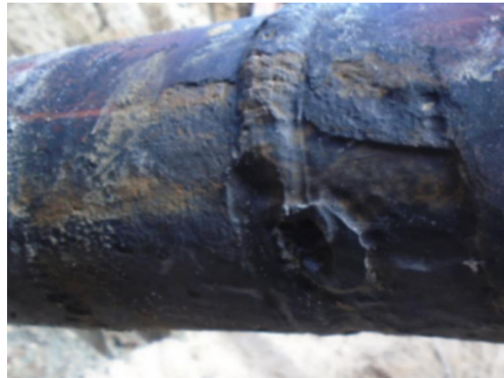
Figura 8 - Destaque para o furo em tubulação de GLP ocasionado por falha no revestimento
