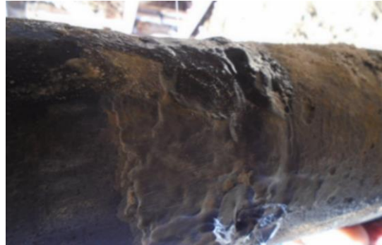
Figura 7 - Furo em tubulação de GLP ocasionado por falha no revestimento
