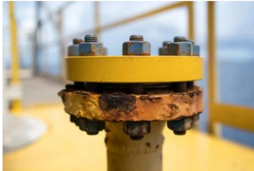
Figura 6 - Tubulações corroídas industriais
