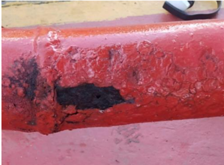
Figura 3 - Tubulação do Sistema de Combate a Incêndio furada devido a ação da maresia
