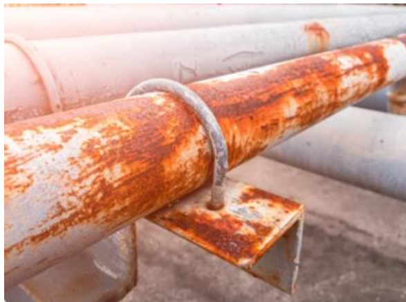
Figura 2 - Tubulações corroídas industriais
