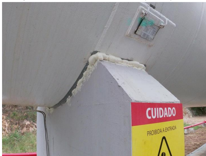
Figura 1 - Transbordamento excessivo da espuma expansiva
